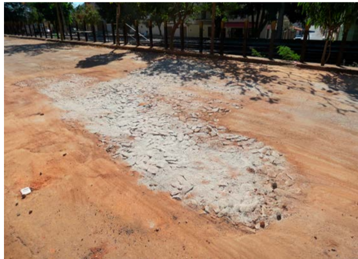
Buracos Avenida Lenhita
